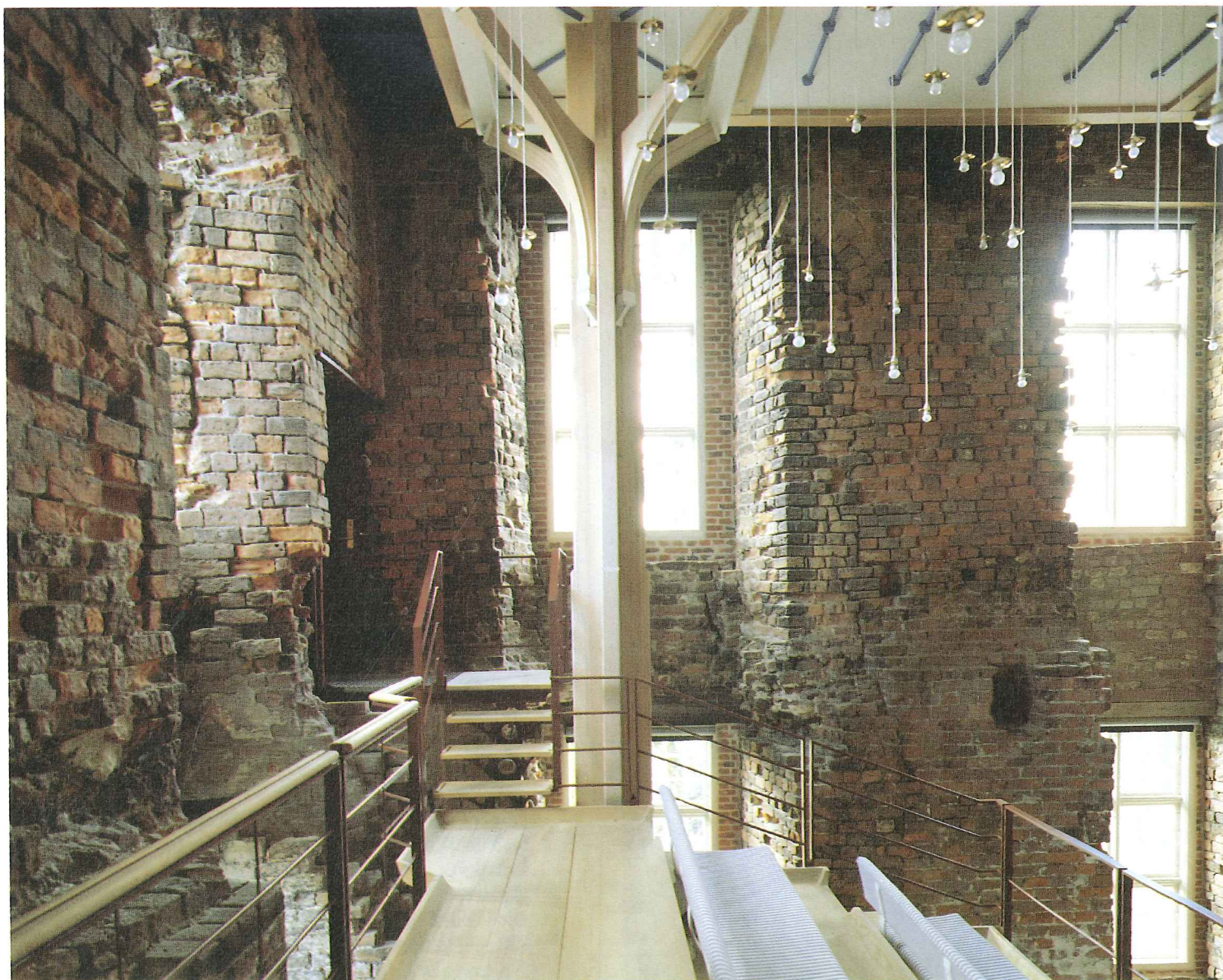
På bagvæggen ses rester og spor af Chr. III's to etager høje kapelvinduer. Der er adgang til pulpituret fra badstuetårnet til venstre. ■ On the rear wall, can be seen traces of Christian III's two-storey chapel windows. Access to the gallery is from the bath tower.
